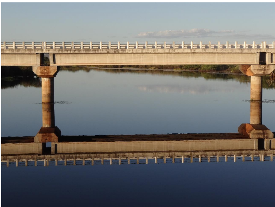
Fig.27 Pontes de concreto, mas sem concreto também é.
